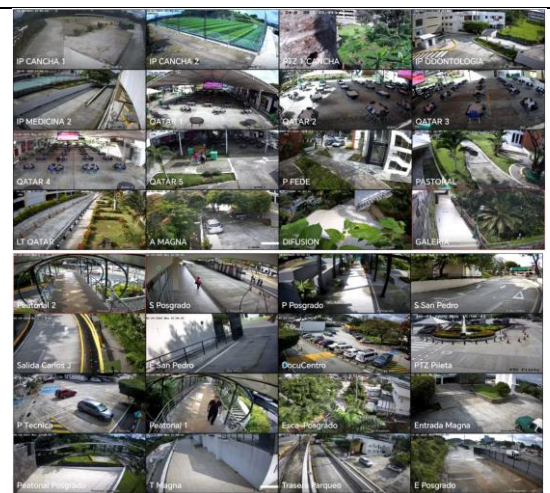
Sistema CCTV, campus
